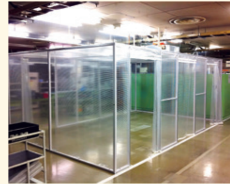
防塵 保温・保冷 ビニールシート、D40レール使用(シート扉)
