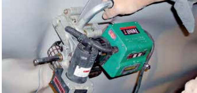
便利なクロスハンドル付きのツイニーTによるトンネルでの頭上溶接。
