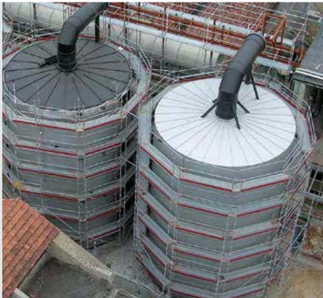
空気浄化システム、スペイン。材質：HDPE
