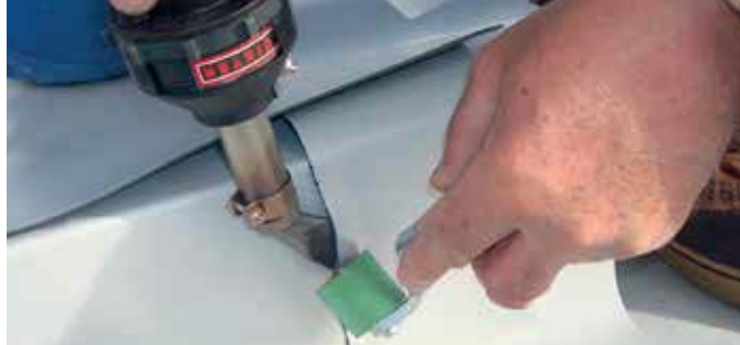
ホットストリームに平型ノズルを装着して防水シートのTジョイント部を溶着しています。
